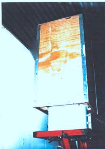
'n Waanier was geïnstalleer om koue lug tussen die geboue se dakke en "Armco" te blaas om die smelting van sneeu te stop
