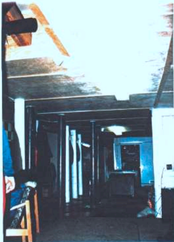
Adisionele staalstutte in die leefarea met die vals plafon in die voorgrond
